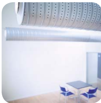
Kanalsystem för ventilation
