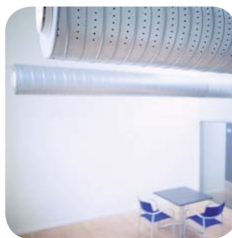
Kanalsystem för ventilation.
