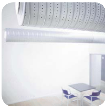
Kanalsystem för ventilation.
