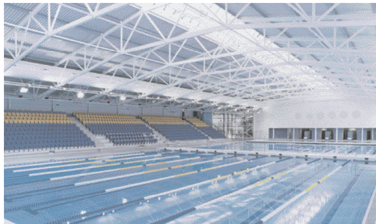
Ventilationssystem och inneklimatutrustning levererat till en simhall.
