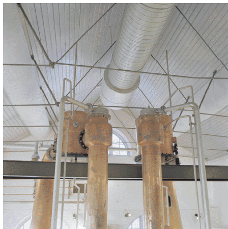
Air Duct systems, whiskytillverkning i Mackmyra.
