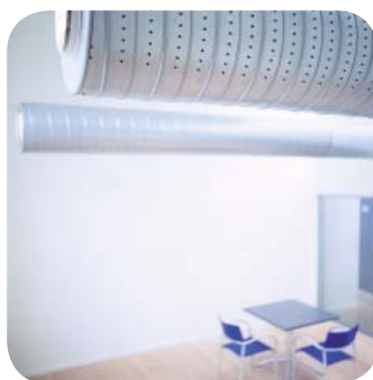
Kanalsystem för ventilation
